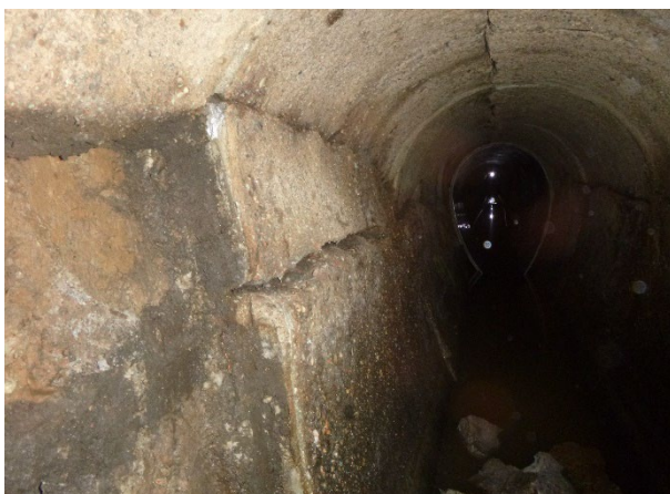
Abbildung 2 – Zustand des Sammlers vor Sanierung
