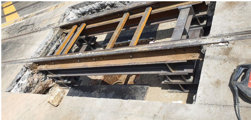
Abbildung 5 fertig montierte Stahlkonstruktion zur Abfangung der vorhandenen Gleise (Quelle FU Robots Rohrsanierung GmbH)
